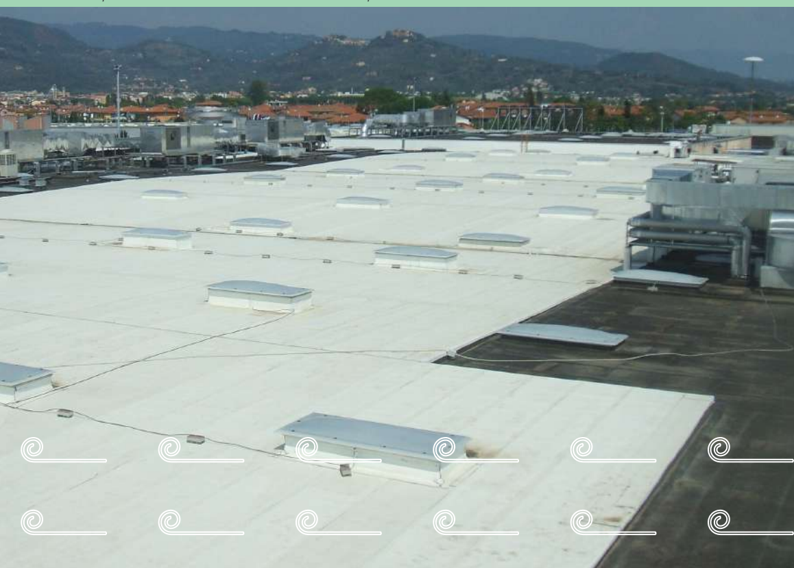
Centro Commerciale Coop Massa e Cozzile - Montecatini Terme (PT): Copertura in membrana bitume-polimero bianca termoriflettente
